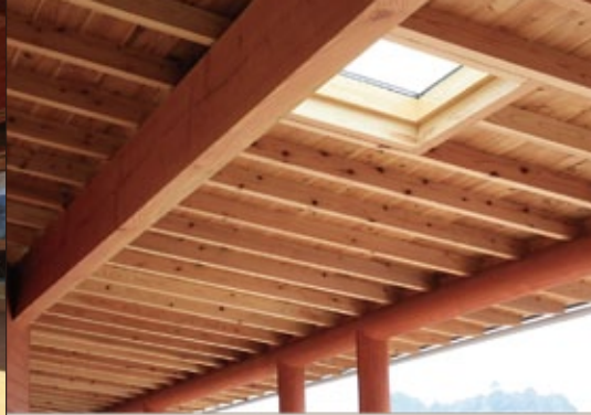
デッキテラスの天窓。軒の深い部分でも天窓から自然の光を取り入れられる。
